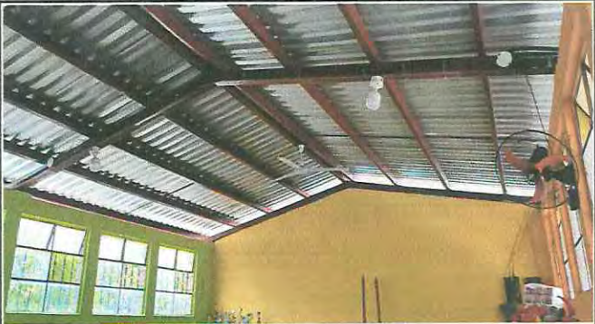
Foto 2: Estructura de soporte de metal de 4x2
