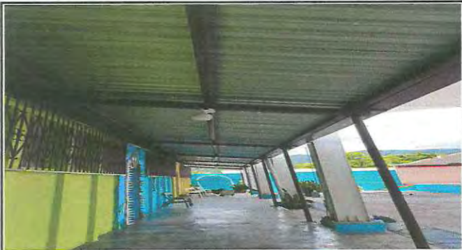
Foto1: Estructura de soporte de metal de 4x2
