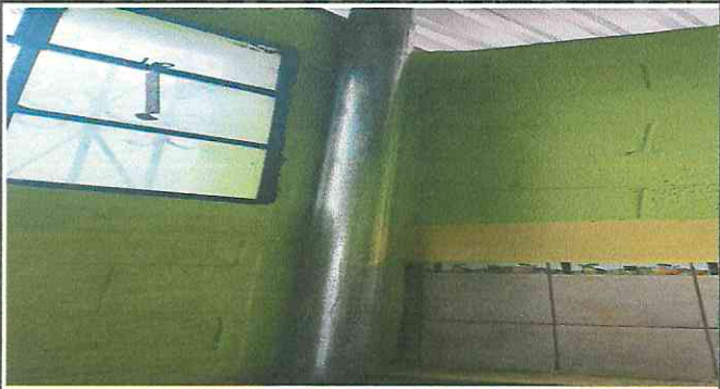
Foto1: Chimenea de metal
