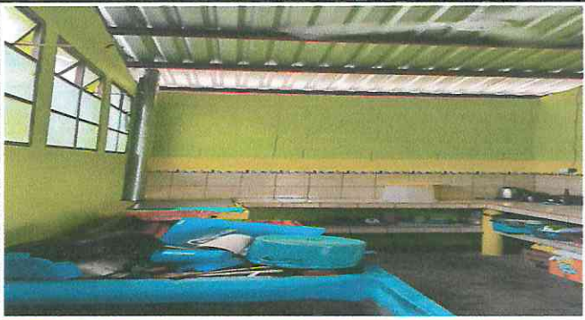
Foto 2: Chimenea de metal
